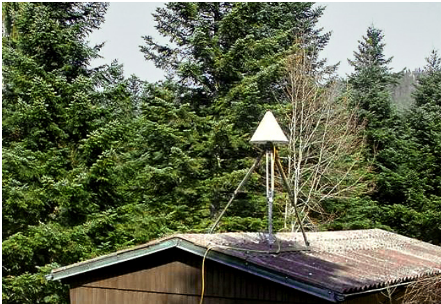
Abb. 1: GNSS-Station BFO1 (Stand: 2005)
