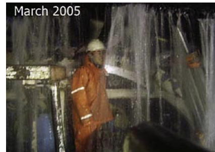
Abb. 9: Arbeitsbedingungen nach Wassereintruch im Headrace-Tunnel
