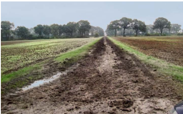
▼ Abb. 6: Zustand des ländlichen Wegenetzes im Verfahrensgebiet – Beispiel Mittelweg
