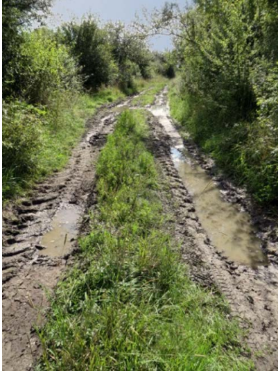
◀ Abb. 5: Zustand des ländlichen Wegenetzes im Verfahrensgebiet – Beispiel Lichterfelder Weg
